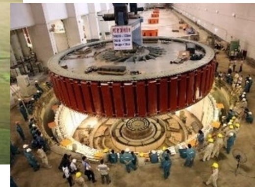
Alternateur de centrale hydraulique
