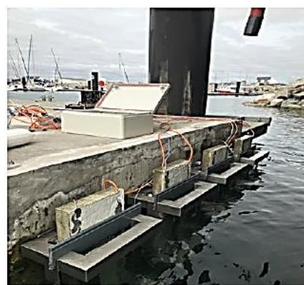
Figure 2 Poutres instrumentées par des capteurs de résistivités électriques et installées au port de La Turballe
