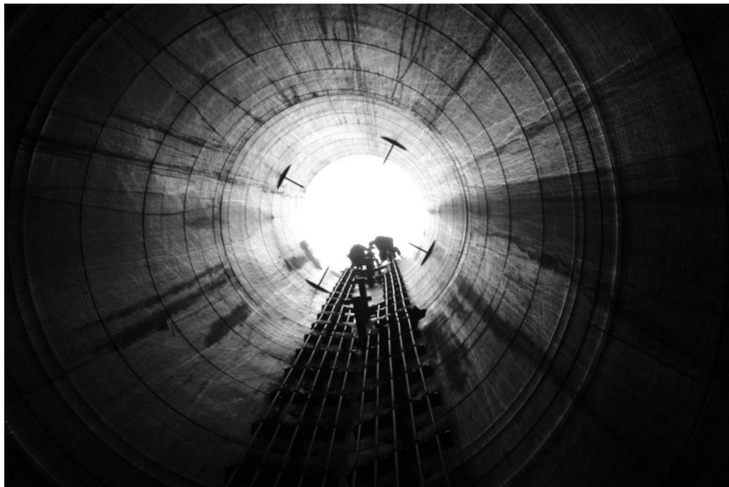
Bâtiment des auxiliaires nucléaires - Raccordement de cannes de prélèvement d'air sur un système se trouvant à l'intérieur de la cheminé
