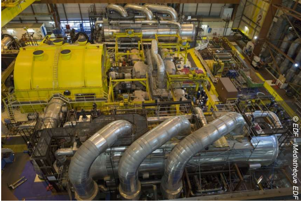
Salle des machines – Nogent
