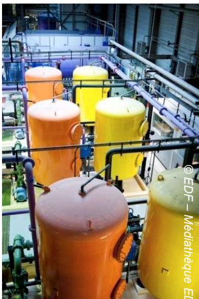
Station de déminéralisation Tricastin
