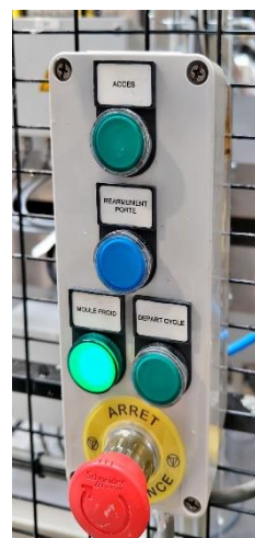
Porte d'accès Gauche réarmée
