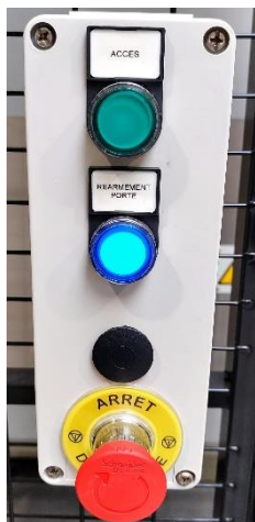
Porte d'accès Arrière/Droite/Avant non réarmée
