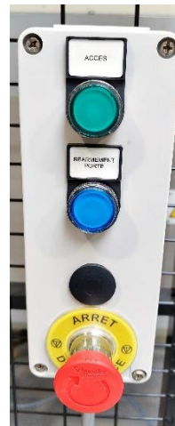
Porte d'accès Arrière/Droite/Avant réarmée
