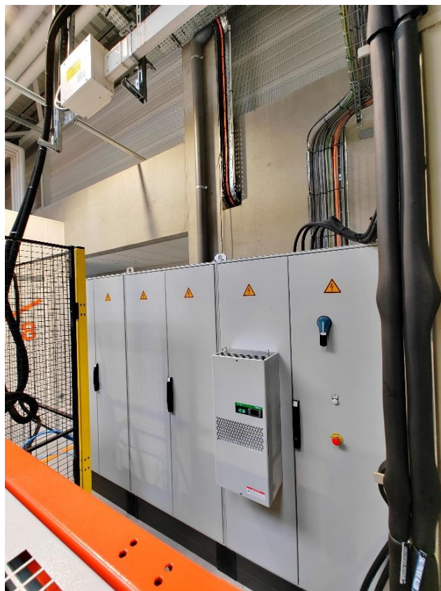
Armoire électrique de la presse PEI
